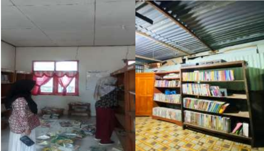
Gambar 4. Kondisi Perpustakaan Sebelum di Perbaiki di UPTD SD Negeri 33 Barru (Kanan) dan UPTD SD Negeri 180 Barru (Kiri)
