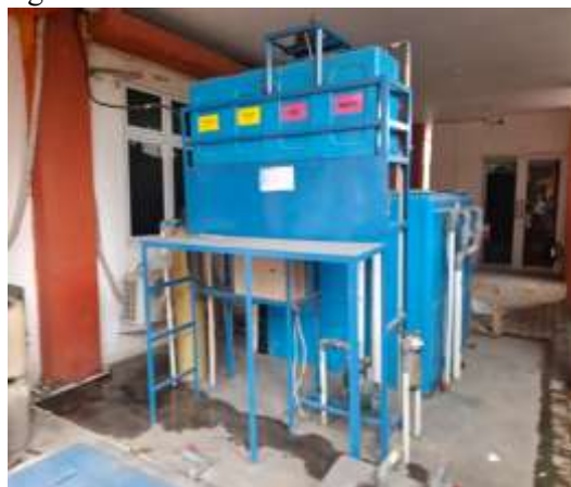
Gambar 3. Instalasi Pengolahan Air Limbah (IPAL) di Labkesda Kota Bekasi
